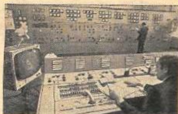
САХА АССР. Бүтүүтүгү ГЭС үлэһэ иһитиниэртэн 12 миллиард 894 мунуурун киловатт-часе электро- энергияны өгөрөт таһаарда. Бу—ирбэт том зониты- тар тураллубут аам бастагы гидро-түтүү. Вилигин станция икки уочкага үлэллэр тураллар, үһүс уоч- кага түтүү сагалалла.
